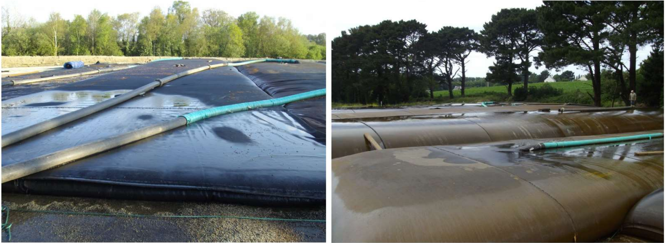
Figure 9 : Stockage de sédiments issus du dragage du port de Morlaix (source : Tencate)
